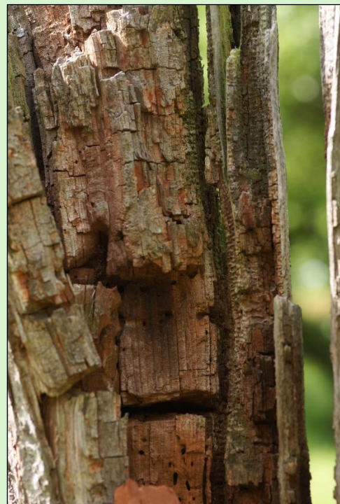
Durch Pilzbefall verursachte Braunfäule
